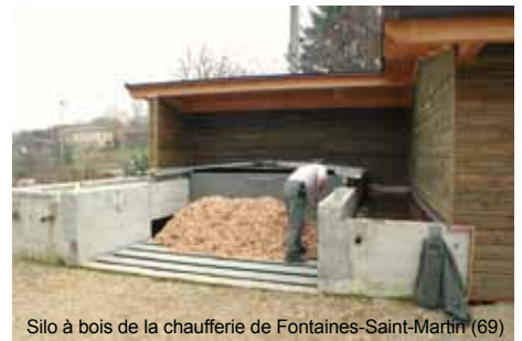
Silo à bois de la chaufferie de Fontaines-Saint-Martin (69)
