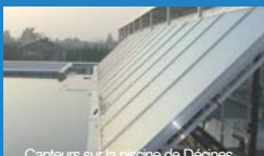
Capteurs sur la piscine de Décines
